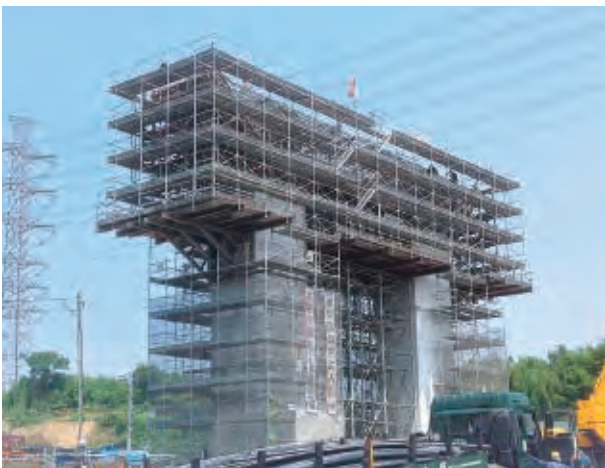
ASブラケット+自在トラス+支保工+足場+ASホルダー+ベント材
